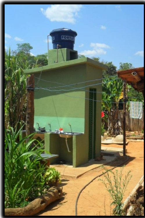
(Figura 7 – Módulo Sanitário Domiciliar. Autor(a): Marina Santos. Data: Set. de 2013)
