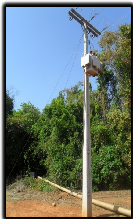
(Figura 11 – Transformador da bomba de água. Autor(a): Marina Santos. Data: Set. de 2013)
