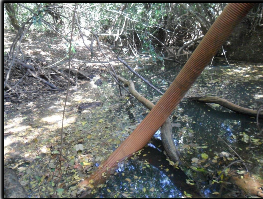
(Figura 10 – Cano de sucção da bomba de água. Autor(a): Marina Santos. Data: Set. de 2013)
