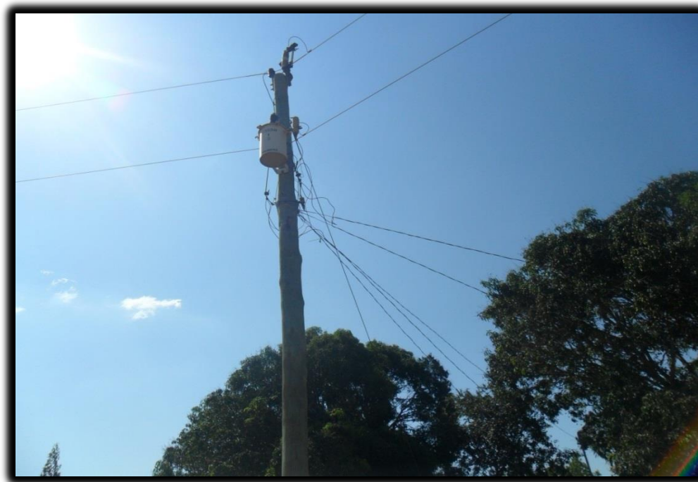
( Figura 4 – Transformador que leva energia à comunidade. Autor(a): Marina Santos. Data: Set. de 2013.)
