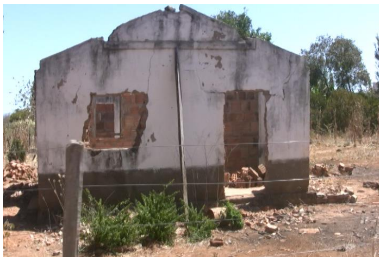
Foto 9: Casa abandonada no interior do PNCP. Fonte: Amores no Velho Chico
