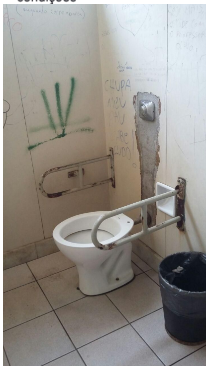
Figura 2 – Banheiro em más condições
